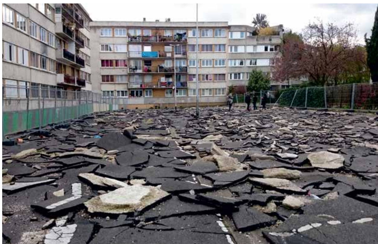
Opération de déscellement d'un enrobé de parking à Aubervilliers (93). ©Wagon Landscaping
