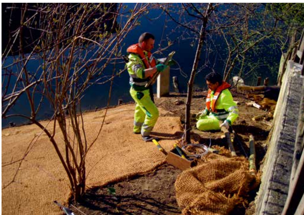
Fascinage de saules réalisé par l'Association Espaces sur l'île Saint-Germain à Issy-les-Moulineaux (92) pour stabiliser et revégétaliser les berges. ©Association Espaces
