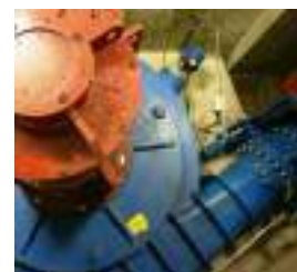
La turbine transformant l'énergie hydraulique en électricité
