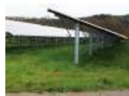
Surélévation des panneaux pour raison d'inondabilité
