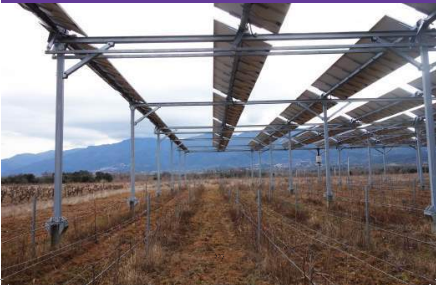
La parcelle en agrivoltaïsme du domaine de Nidolères, une structure métallique imposante
