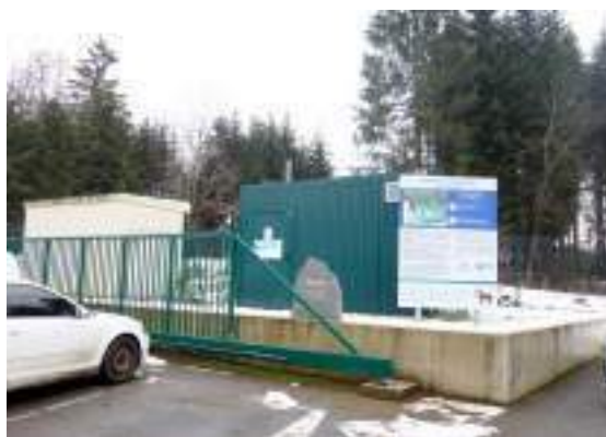
Poste électrique de redistribution sur le réseau GRDF
