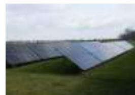
Panneaux photovoltaïques au sol devant les locaux de la régie
