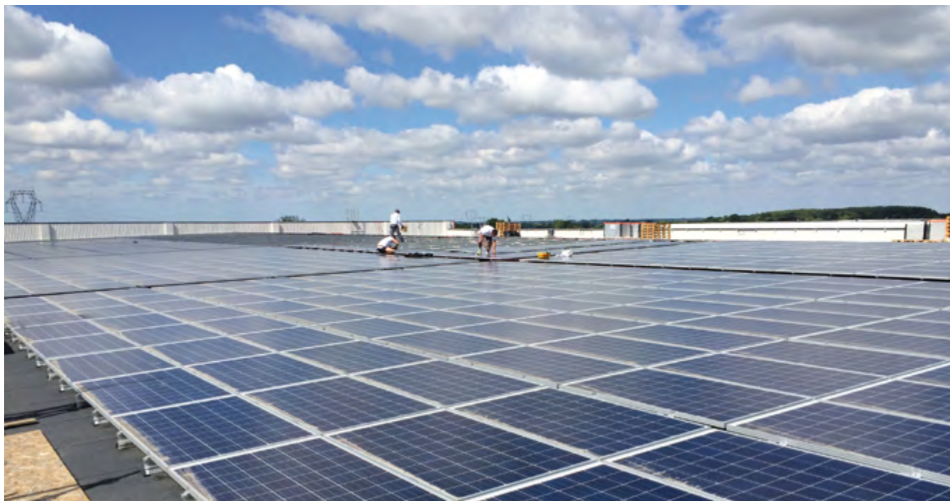
La toiture photovoltaïque « Soleil du Grand Ouest », à Melesse
