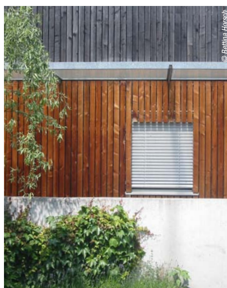
La partie inférieure, entièrement protégée de la pluie mais exposée au soleil, a pris une couleur brune après neuf ans de service.
