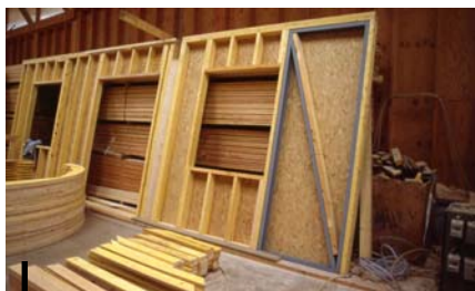
Intégration de cadres métalliques dans les panneaux pour répondre aux contraintes sismiques.
