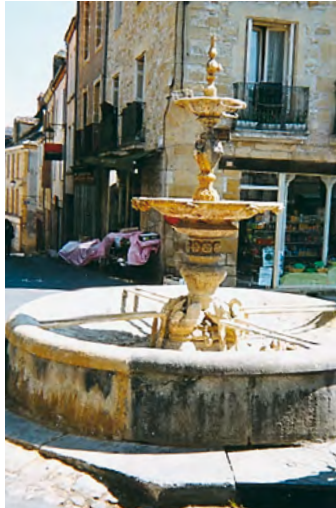
La fontaine avant restauration
