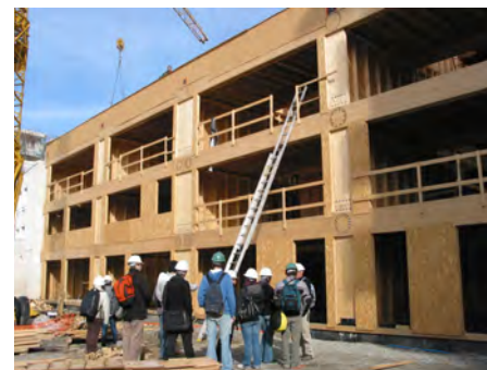
Le développement d'une filière "bois" locale a permis la construction d'un projet d'immeuble à ossature bois.
