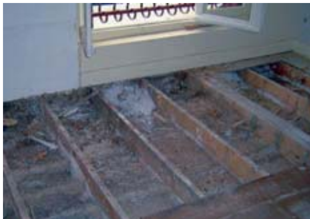
Constat d'un solivage sous-dimensionné (Source FFB-CMP)
