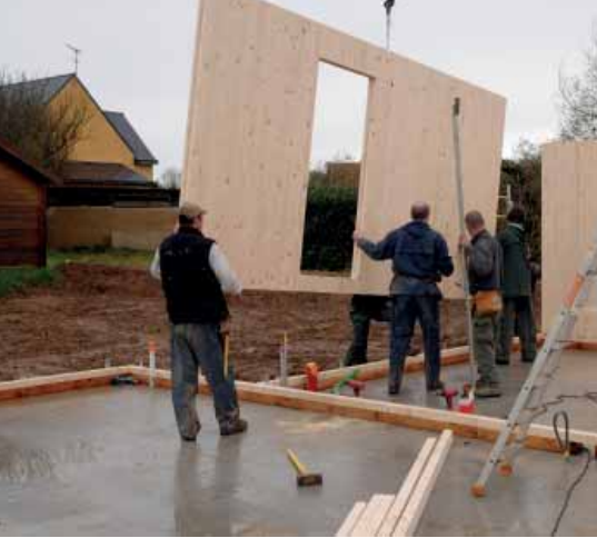
Maison bois massif - Architecte Pascal Adam - crédit photo : Jean-François Chauchard Plougonvelin - Finistère
