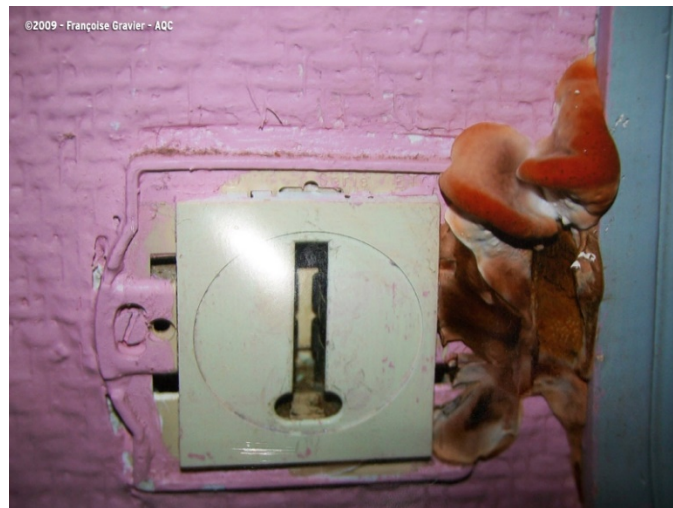
Figure 13 - Développement d'un champignon dans une prise téléphonique, dû à un défaut de ventilation. (Source : AQC)
