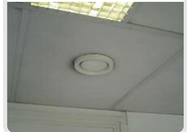
Photo 10 : Bouche de soufflage d'air dans une cantine
