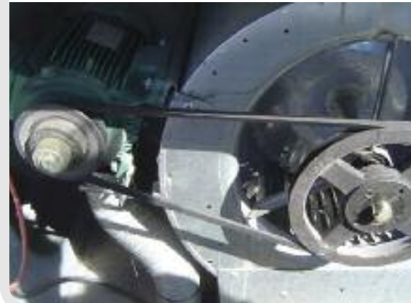
Photo 2 : Courroie ventilateur en bon état
