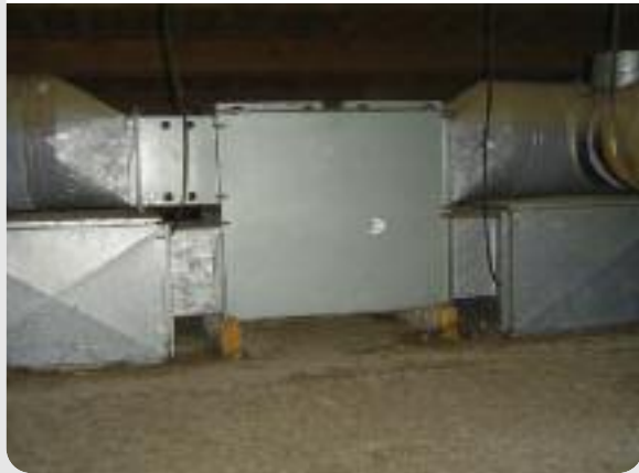
Photo 1 : Centrale double flux dans des combles
