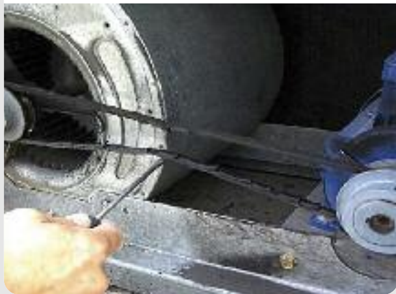
Photo 3 : Courroie ventilateur en mauvais état
