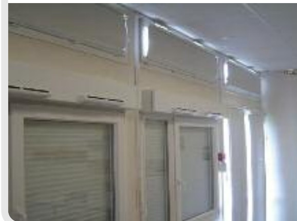
Photo 9 : Entrées d'air dans un dortoir
