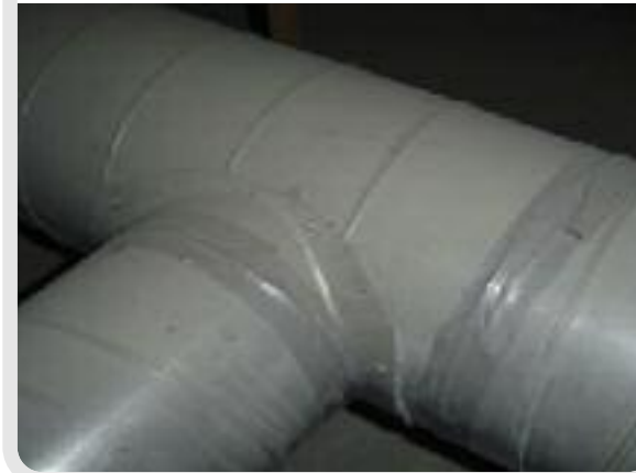
Photo 5 : Conduits étanches en combles
