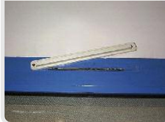
Photo 7 : Entrée d'air avec réservation trop étroite
