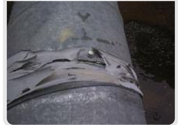
Photo 6 : Adhésifs détériorés sur conduits extérieurs
