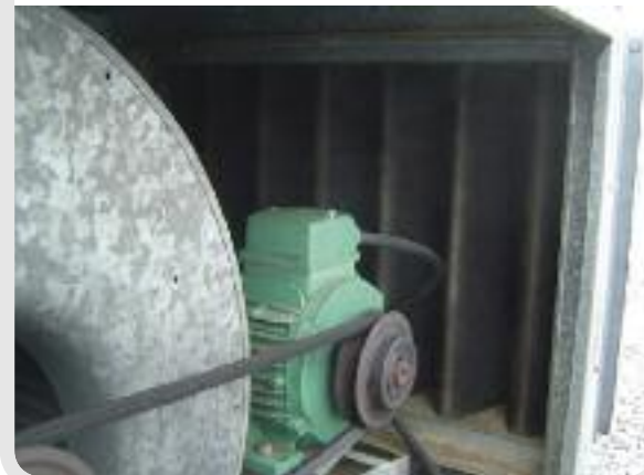
Photo 4 : Intérieur CTA avec filtre à air
