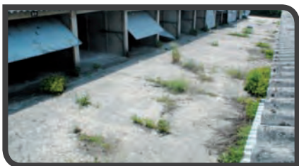
Les surfaces de stationnement en matériaux coulés souffrent dès qu'elles commencent à s'user et se fissurer.
