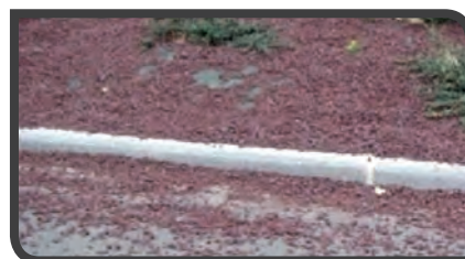
Au bord des allées, les massifs en surhauteur posent les problèmes de ruissellement et débordement des paillages qui favorisent l'installation des plantes sur les revêtements de circulation.
