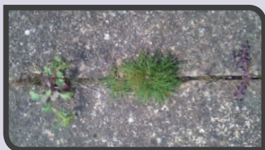
► Végétation entre les joints
