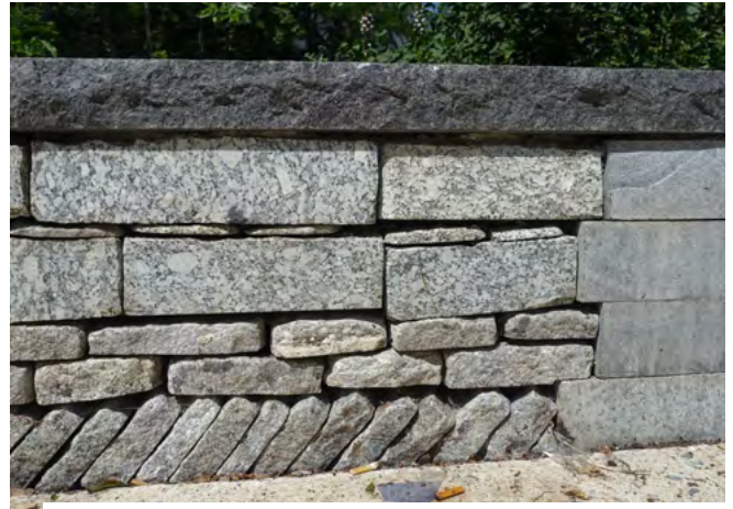
Ce mur récent créé dans le cadre d'un aménagement paysager a été réalisé grâce à des pierres de récupération. De plus, il valorise la technique de la pierre sèche et le métier de murailleur. Malheureusement, il présente des défauts pour l'accueil de la biodiversité comme le couronnement en débord et des pierres sciées à la surface lisse. | © Sandrine LARRAMENDY
