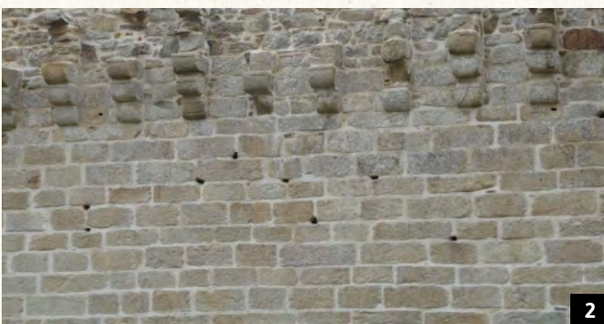
1 - Photographie repérant les nids de martinets existants avant les travaux. 2 - Photographie après les travaux avec maintien des cavités existantes. | © LPO44
