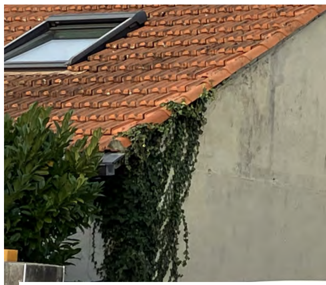
Ce lierre a atteint la gouttière et menace la toiture, il doit être enlevé pour préserver la toiture. | © Sandrine LARRAMENDY
