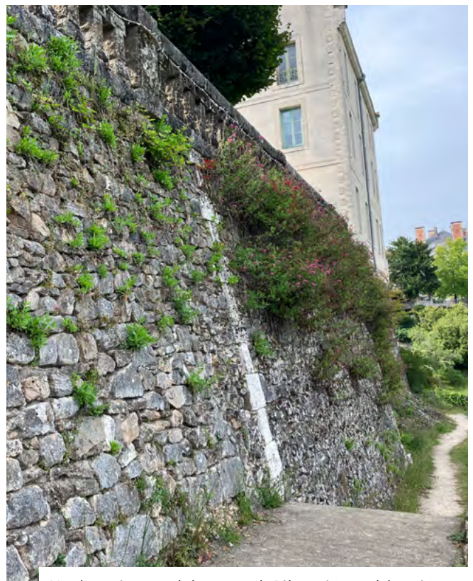
Mur de soutènement de la terrasse du Pôle expérimental des métiers d'arts de Nontron (24). Les nombreux murs de cette petite ville de Dordogne sont en pierres calcaires maçonnées. | © Sandrine LARRAMENDY
