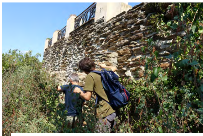
La terrasse du Rayolet est située en surplomb sur la Méditerranée. Le mur de soutènement en pierres maçonnées présente des traces de rejointoiement assez récents. | © Domaine du Rayol et Sandrine Larramendy
