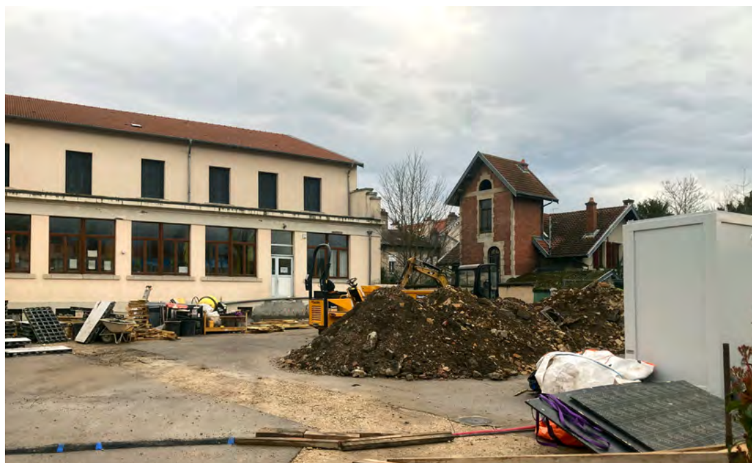
Travaux d'aménagement et de végétalisation de la cour de l'école Jules Ferry à Malzéville. / C. Schwartz
